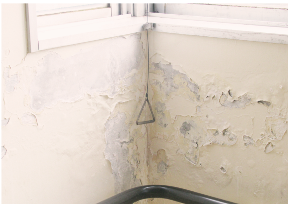
老朽化により剥がれおちる壁 (国立障害者リハビリテーションセンター)
